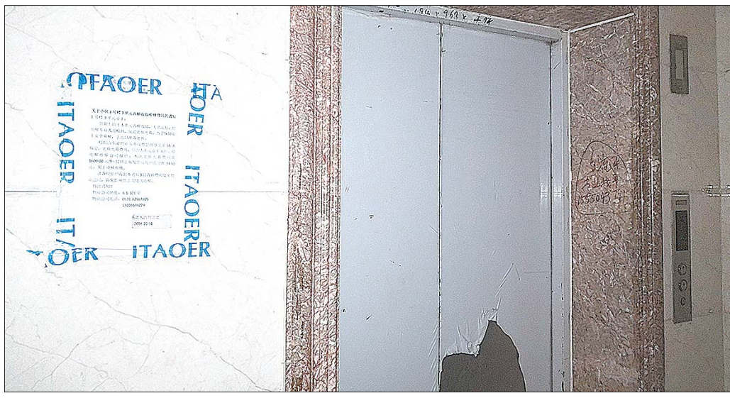
出现故障的电梯仍处于停运状态。
